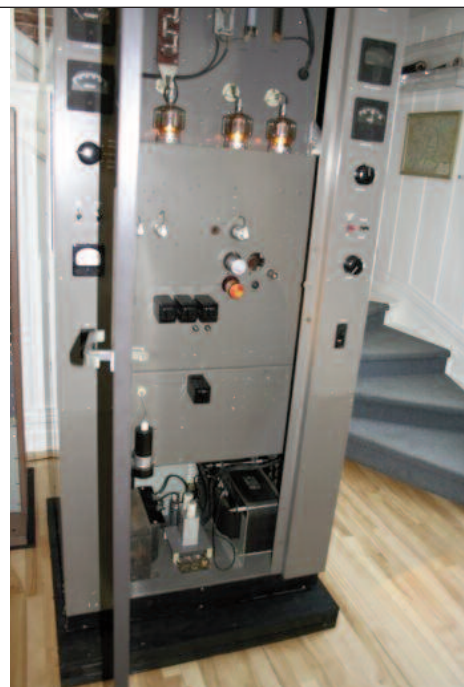
Un PA de 1 KW très largement dimensionné.
